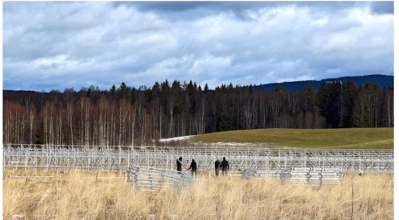
Förberedelsearbetet för den stora solcellspark som ska sättas upp på en åkermark längs E16 strax utanför Djurås är igång. Bild: Johanni Sandén
